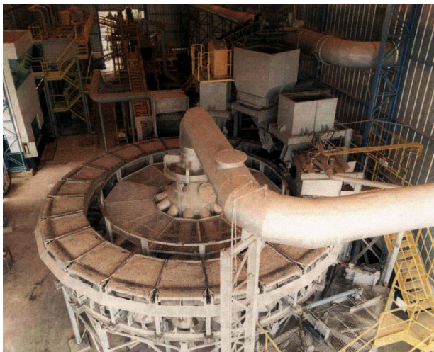
Figure 5. Mini sinter plant.
